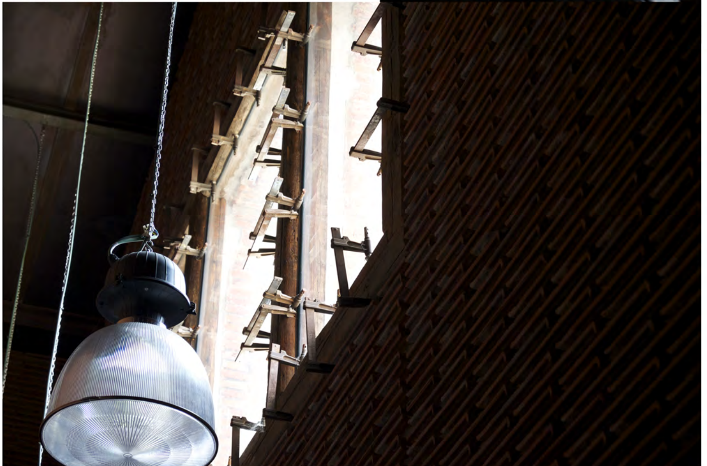
Vice clamps left on timber caprtenry, Nave 8b Arturo Franco. Courtesy Arturo Franco.
